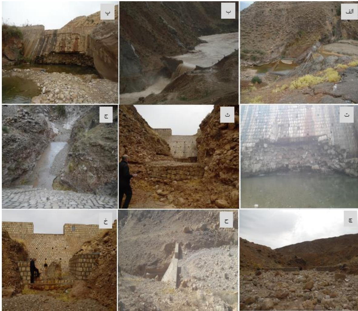
شکل ۳- نمایی از موقعیت سازه و حوضچه آرامش بند شماره ۱ (الف)، عبور سیلاب از روی سرریز بند ۲ (ب)، وضعیت تخریب در محل اتصال جداره پایین‌دست سرریز به حوضچه آرامش در بند ۲ (پ و ت)، وقوع تخریب در حوضچه‌های آرامش سایر بندها (ث و ج) رسوبگذاری (چ و ح) و عدم اجرای پوشش سنگریزه‌ای در پایین‌دست حوضچه آرامش (خ) در برخی از مخازن بندها
